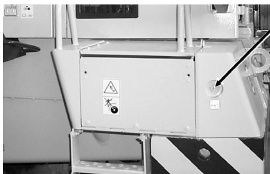
Рис. 4.13. Главный выключатель системы электрооборудования
