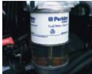
Filtre de retenue d'eau
