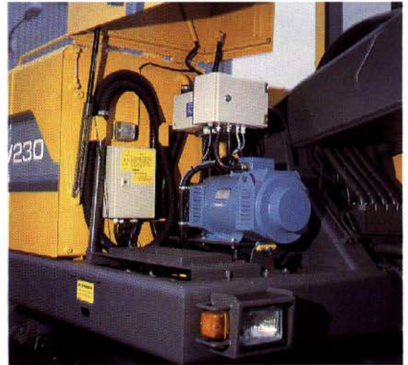
Generatorinstallation för drivning av lyftmagnet.
