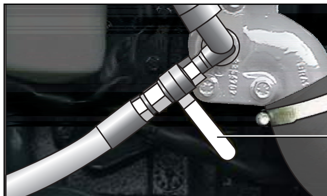
Llave de Paso Agua Caliente Cerrado
